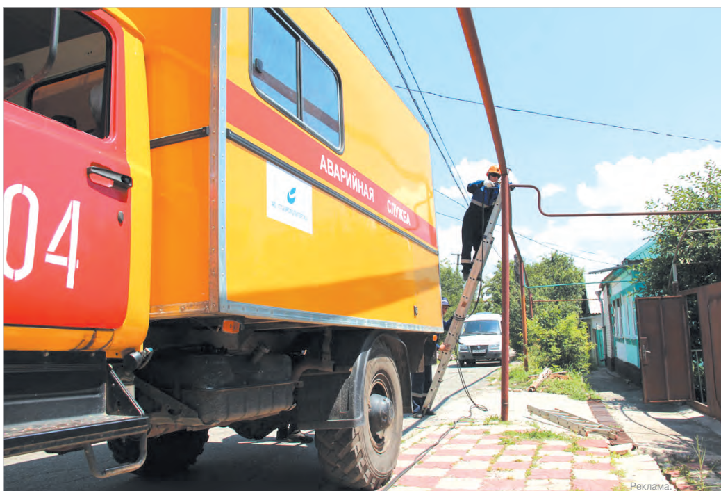
Отключение абонентов от системы газоснабжения.
